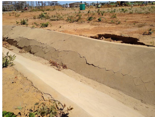
Figura 4. Vista geral do canal SN10 com a presença de colapso do revestimento com perda de sustentação da seção hidráulica.
