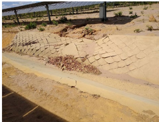
Figura 3. Vista geral do canal SN5 com a presença de colapso do revestimento com perda de sustentação da seção hidráulica. Trecho com existência de travessia de tubulação elétrica.
