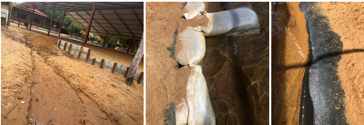
Figura 2. Erosão típica e sistemas empíricos de contenção da areia da praia.
