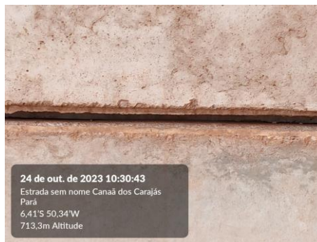
Figura 17 – Detalhe da junta do segundo painel mais inferior, com abertura medida de 18mm, após a conclusão total do aterro.
