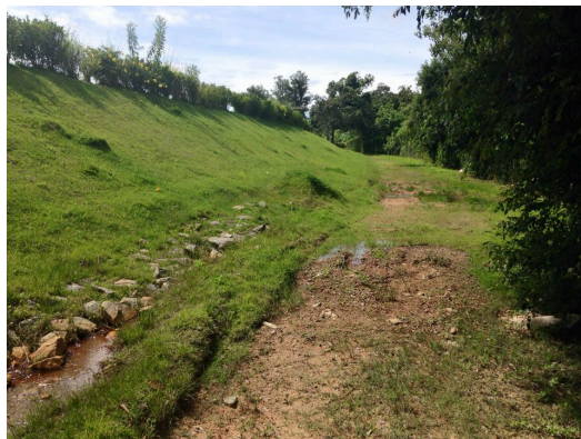
Figura 2. Detalhe do dreno de enrocamento no pé do talude da lagoa trabalhando afogado pelo percolado.
