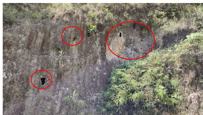
Figura 7 – Orifícios identificados no maciço.
