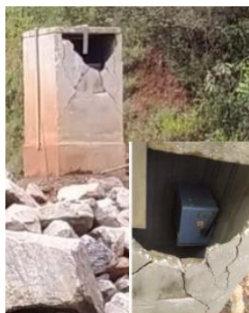
Figura 8. Exemplo de Tiltimeter danificado por maquinário em campo (Autor, 2022)
