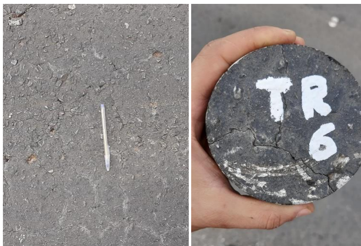
a) Observação das trincas no pavimento. b) Extração de testemunhos para observação.
