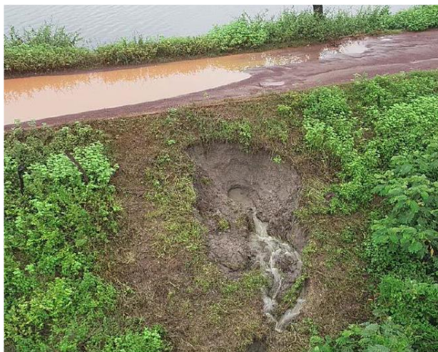
Figura 2. Surgência indicando erosão tubular regressiva, talude de jusante.
