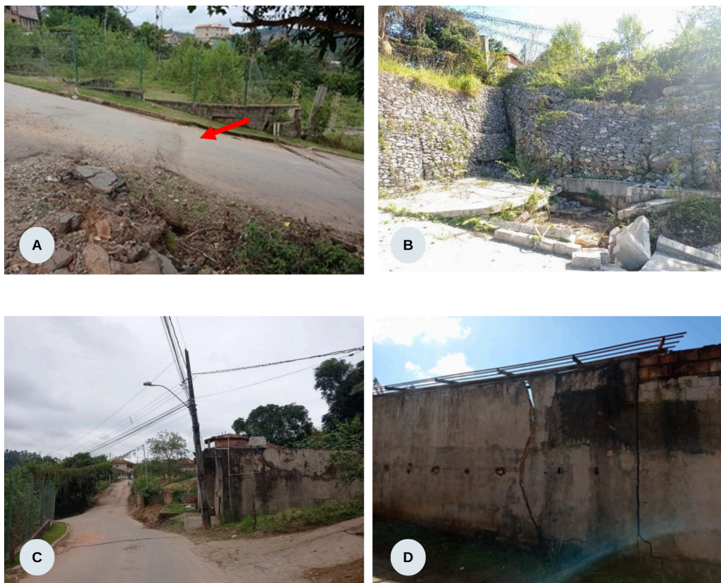
Figura 1 – Indícios do rastejo: A) abatimento da via; B) deformação do muro de contenção; C) poste inclinado; D) trincas nas paredes.
