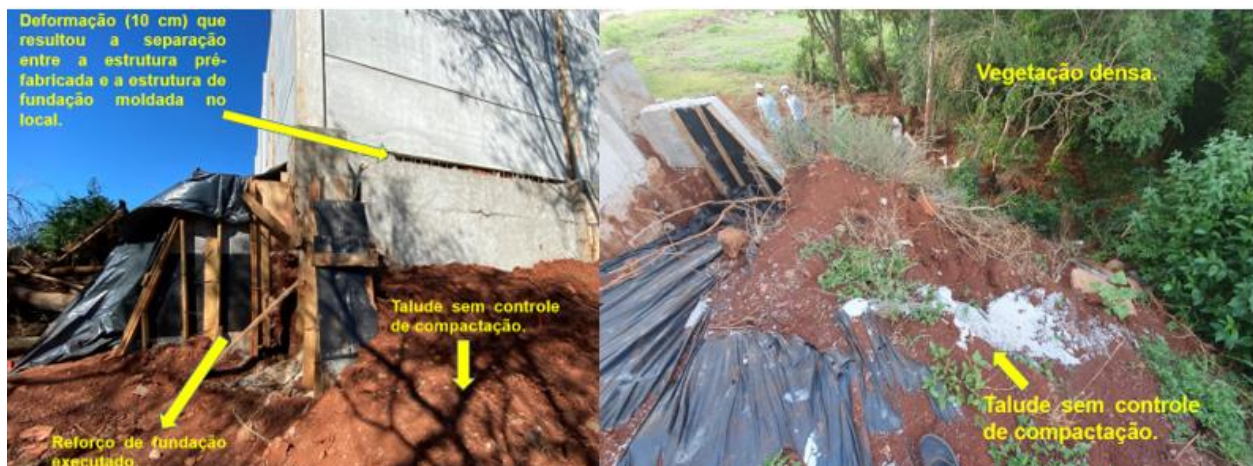
Figura 1. Situação Inicial Encontrada no Talude na Fachada Norte e Leste, Respectivamente.
