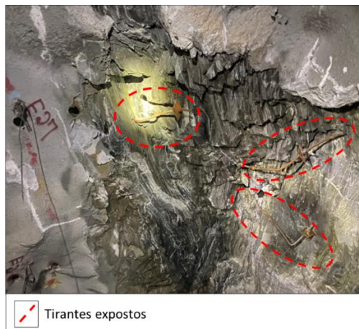
Figura 4. Exposição de tirantes resinados em zona de plastificação do concreto projetado.
