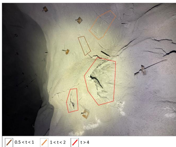
Figura 2. Trincas de diferentes classificações no concreto projetado.
